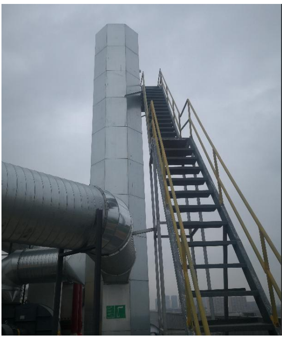
DA001 排气筒监测孔及采样平台
