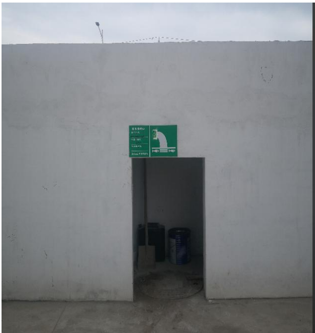
雨水排放口标识牌
