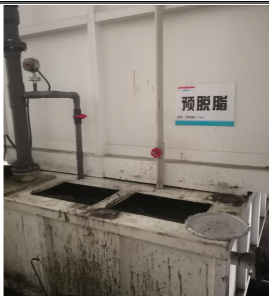
预脱脂废水槽
