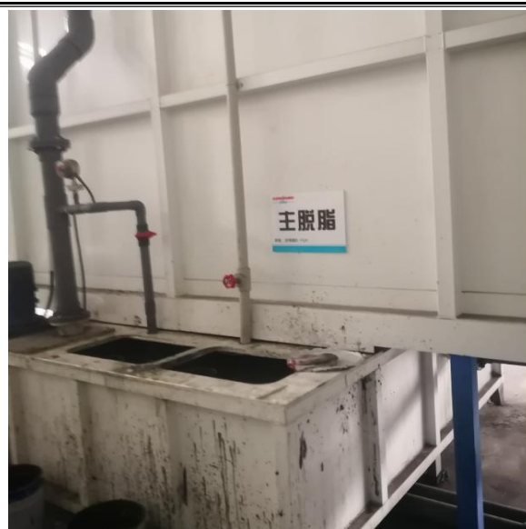
主脱脂废水槽
