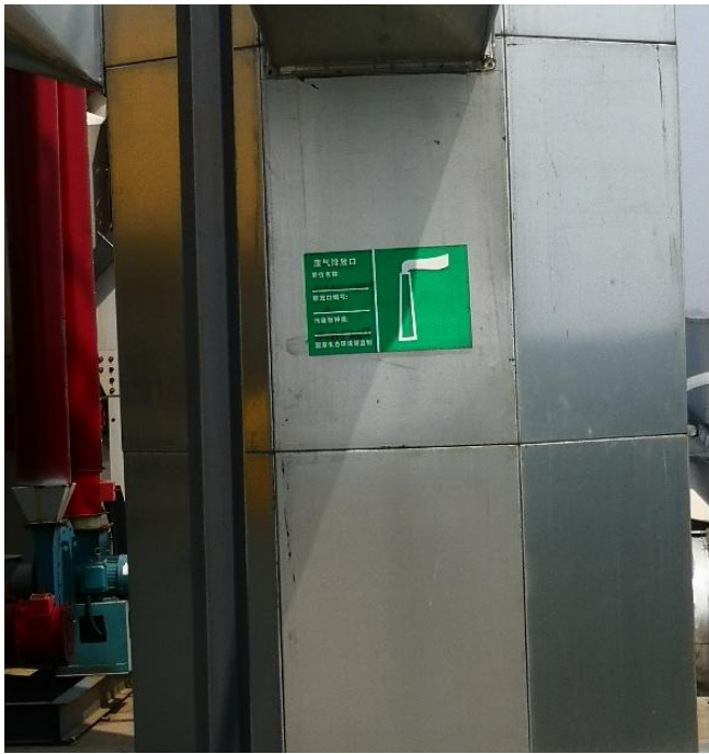
DA001 排气筒标识牌
