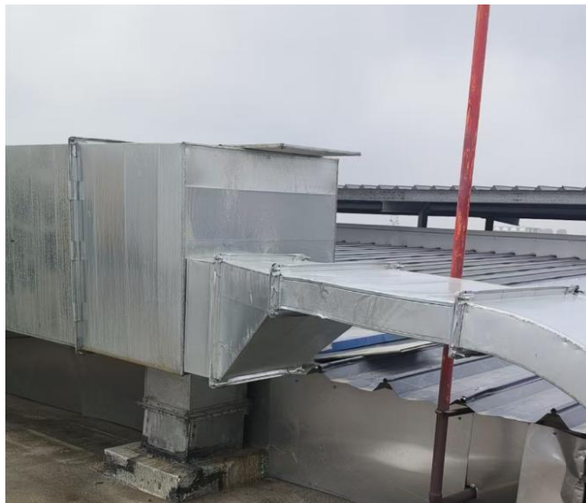
喷粉废气收集管道
