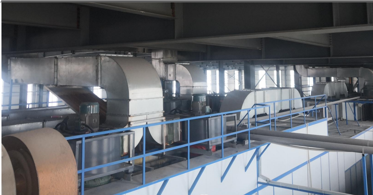
噴漆、噴粉廢氣管道
