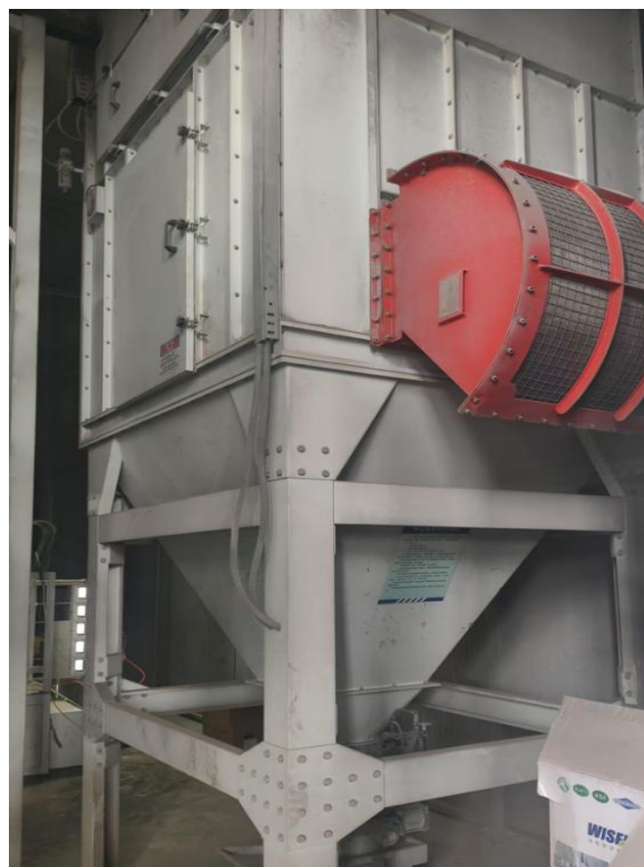
滤筒除尘装置
