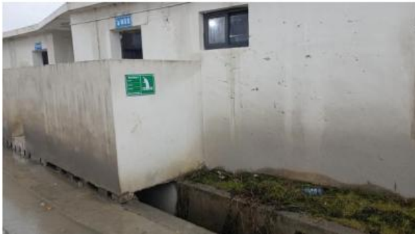
雨水排放口标识牌
