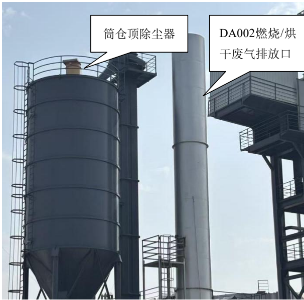
粉尘收集筒仓顶除尘器+DA002燃烧/烘干废气排放口
