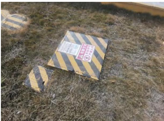
110kV升压站B污水处理设备
