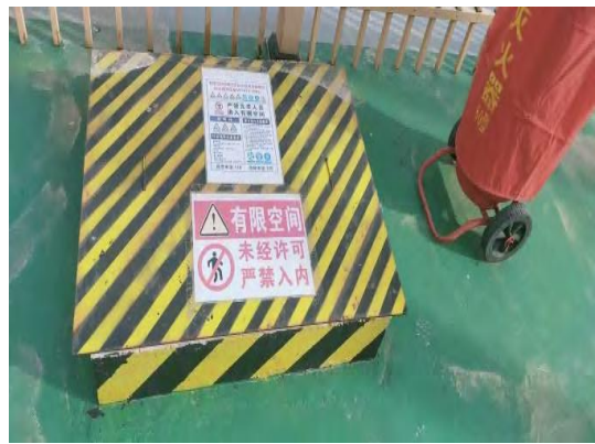
110kV升压站A事故油池
