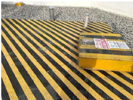
220kV升压站事故油池
