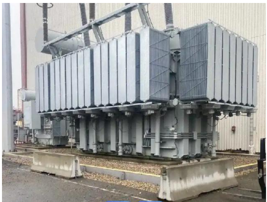
主变压器下方集油坑
