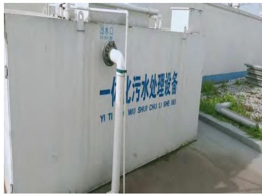
110kV升压站A污水处理设备
