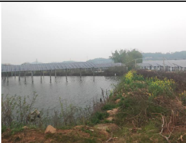
油榨湖区域光伏组件
