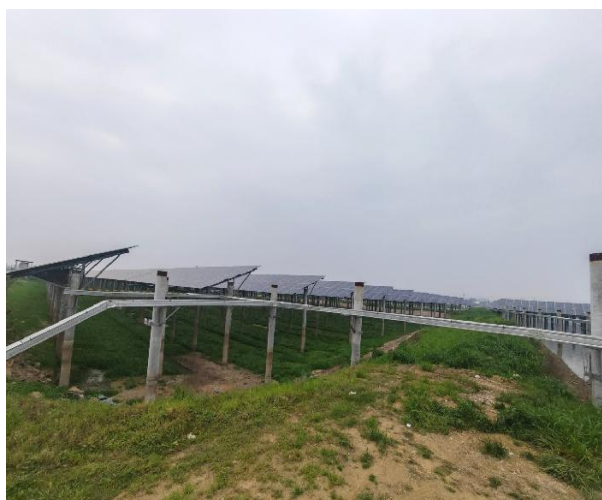
涂家湖区域光伏组件
