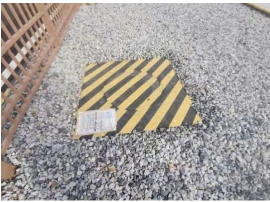
110kV升压站B事故油池
