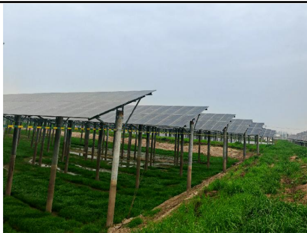
策湖区周边光伏组件
